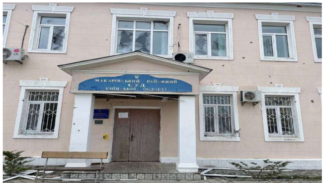
Ірпінський міський суд Київської області - вибито майже всі вікна, пошкоджено двері та фасад будівлі, а також частково викрадено комп'ютерну техніку та систему відеоспостереження.
