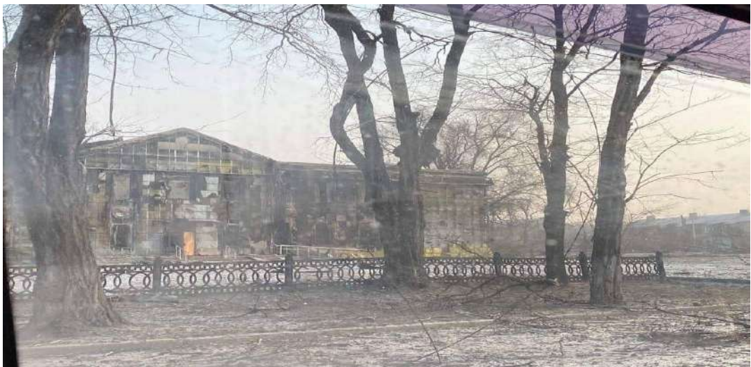
Приморський районний суд м. Маріуполя Донецької області - в суді вибито вікна, внаслідок влучання снаряда пошкоджена покрівля. У зв'язку з тим, що м. Маріуполь перебуває в тимчасовій окупації російської федерації, ступінь пошкодження та вартість відновлення встановити неможливо.
