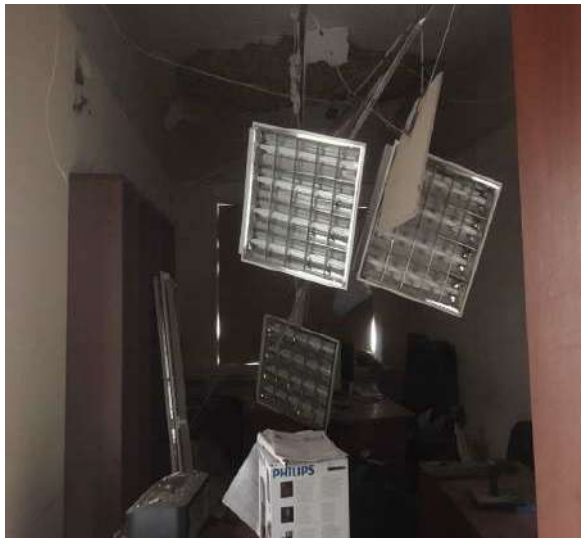
Орджонікідзевський районний суд м. Харкова - пошкоджено фасад будівлі, 22 вікна та 15 одиниць комп'ютерної техніки.
