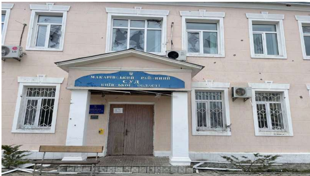
Ірпінський міський суд Київської області - вибито майже всі вікна, пошкоджено двері та фасад будівлі, а також частково викрадено комп'ютерну техніку та систему відеоспостереження.
